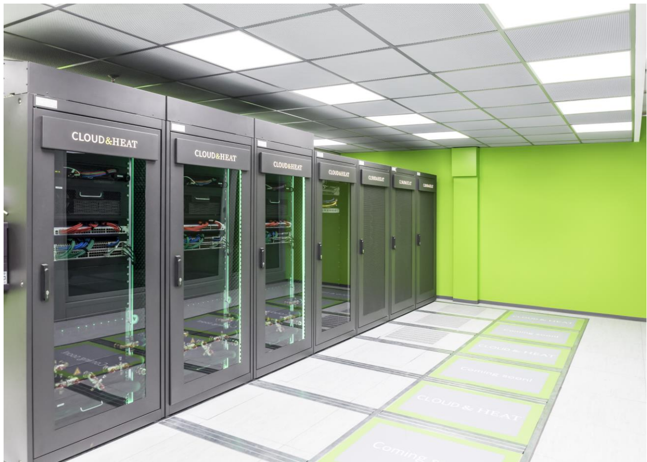
Abbildung 2: Cloud&Heat-Serverraum im Eurotheum, Frankfurt/Main
