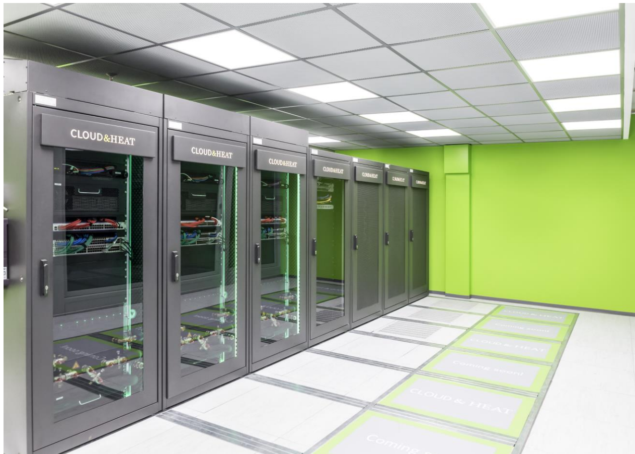
Abbildung 2: Cloud&Heat-Serverraum im Eurotheum, Frankfurt/Main
